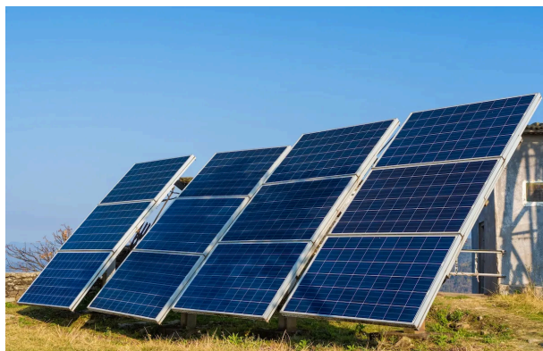
Pembangkit Listrik Tenaga Surya (PLTS)
